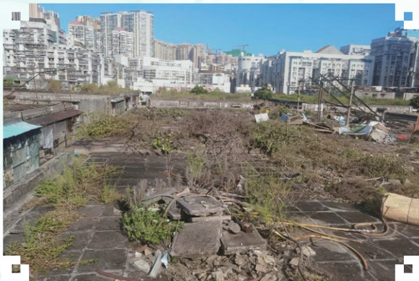
「祐漢七棟樓群」樓宇天面野生樹木蔓延
