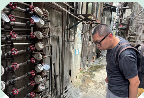
Inspeções periódicas in loco realizadas pela Sociedade nos edifícios do Bairro Iao Hon
